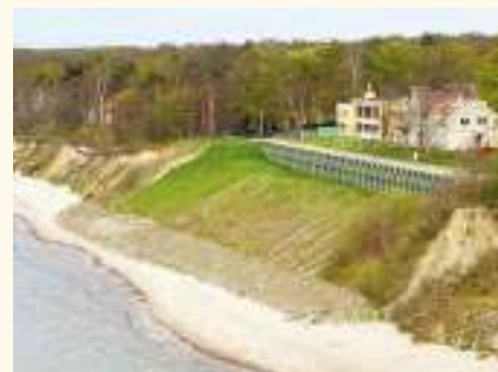
Reperfilamento de talude em Rewal. O principal problema neste local é a inadequada gestão dos recursos hídricos. É visível uma acentuada erosão nas proximidades. (foto: Piotr Domaradzki)
